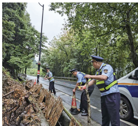
公路隐患排查
