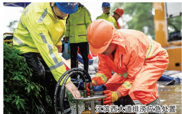
江滨西大道排涝应急处置
